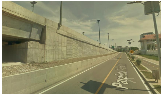
Escamas de concreto
