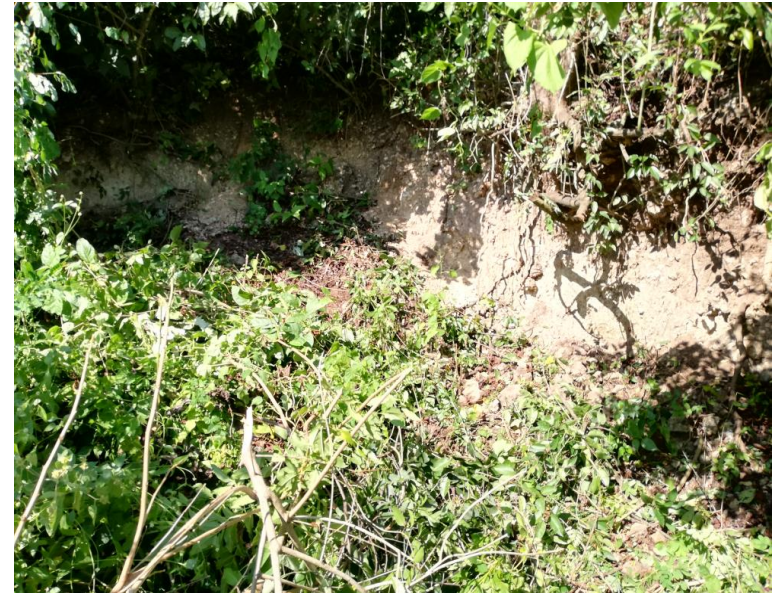
Cicatriz de deslizamiento antiguo
